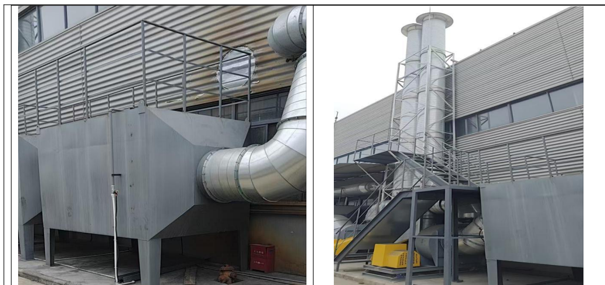
图 4-1 废气处置设施现场图
