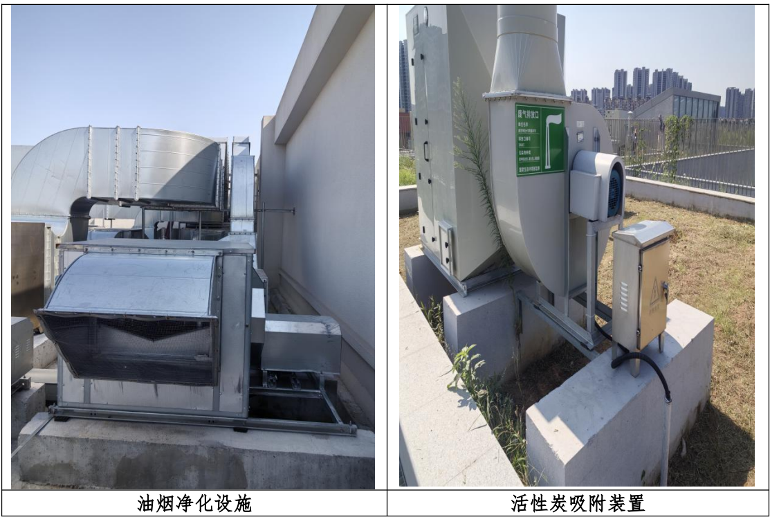
图 4-2 废气处置设施现场图
